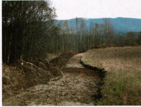
Bilde 26 – Gruslinse i sjakt
